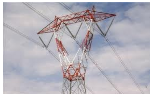
LINEE ELETTRICHE AEREE
