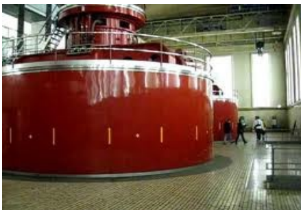
ALTERNATORI DA CENTRALE
