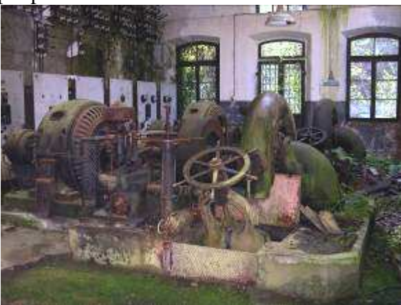
Turbine Francis della centrale dismessa sul torr. Ardo
