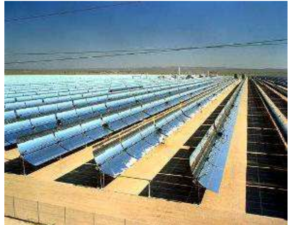
Specchi di un grande impianto solare termodinamico
